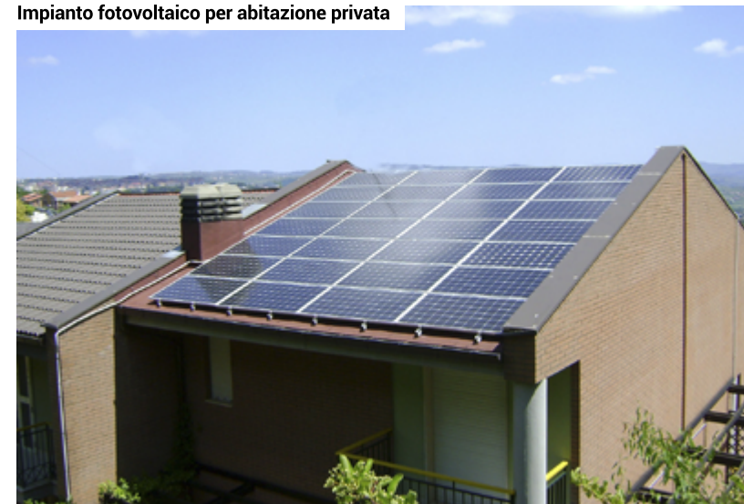
Impianto fotovoltaico per abitazione privata
